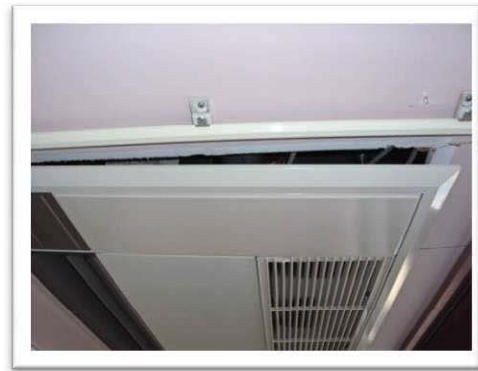
3階居室エアコン吊り器具破損
