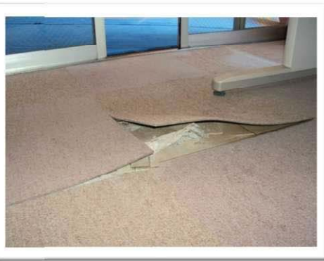
床のめくれ上がったボランティア室
