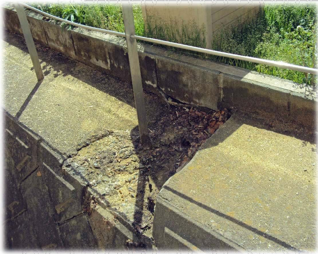
M9.0の威力、施設地階の法面に生じた段差
