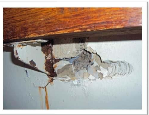
3階廊下の手すり基部破損
