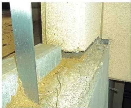
基礎部とはく離れた柱
