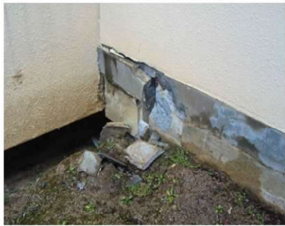
モルタル脱落、ボランティア室
